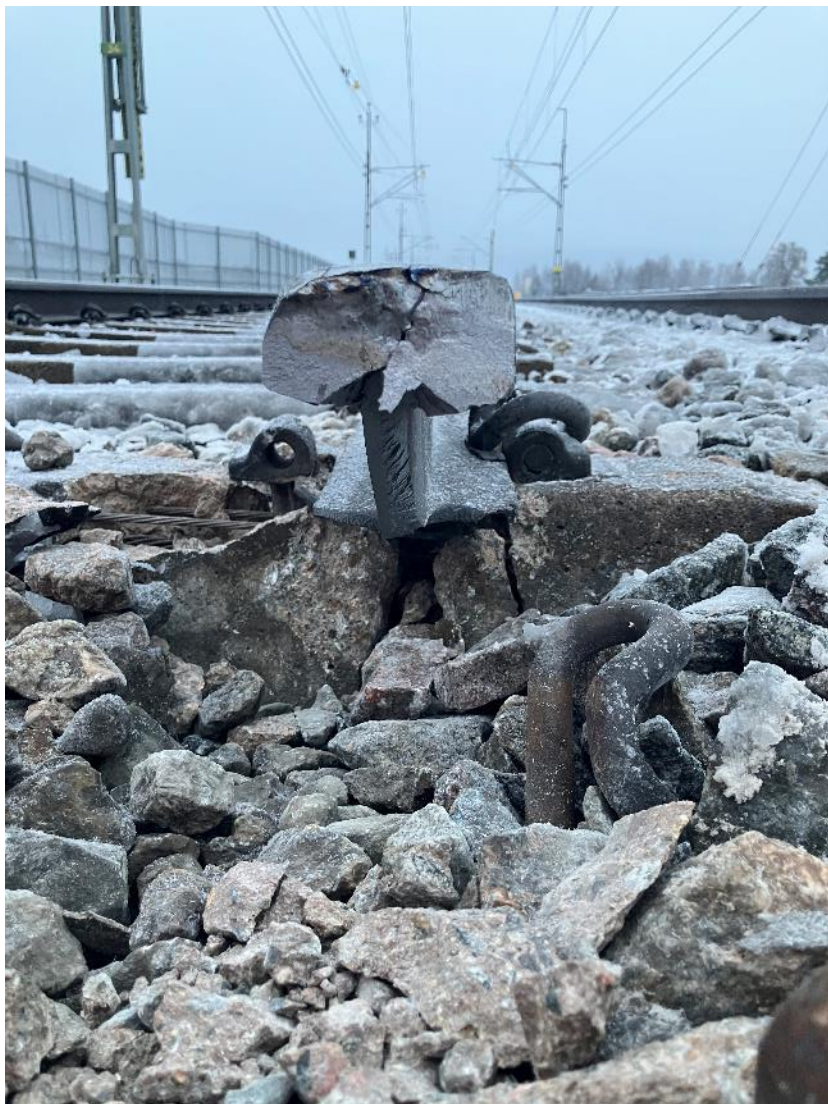
Brottyta ca km 6+451 riktning mot 50 kg spår
