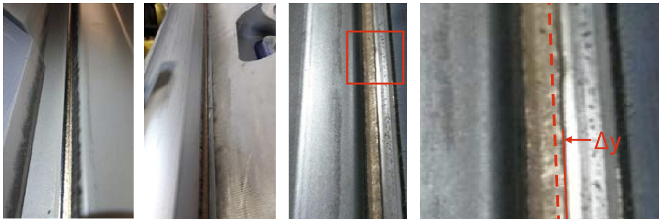
Figur 11. Laserlödning mot el.förzinkade ytor (längst t.v.) ger ett ger ett utseendemässigt bättre intryck jämfört med fogar utförda på varmförzinkad plåt. Ett annat problem är att fastlägga vad som egentligen är att betrakta som godkänd kantkvalitet (t.h.).
