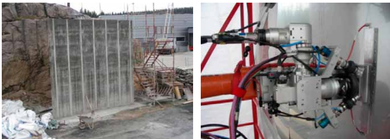
Figur 10. T.v. testväggens utseende innan de rostfria plåtmembranen applicerats och t.h. det robotmanipulerade svetsverktyget från Permanova.
